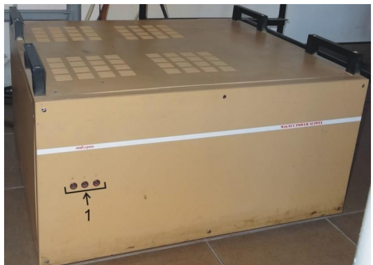
Rys. 5 Fotografia zasilacza elektromagnesu ER-2505. 1- lampki są wskaźnikami włączenia napięcia na poszczególnych fazach „R”, „S” i „T” zasilania trójfazowego (3 x 380 V).
